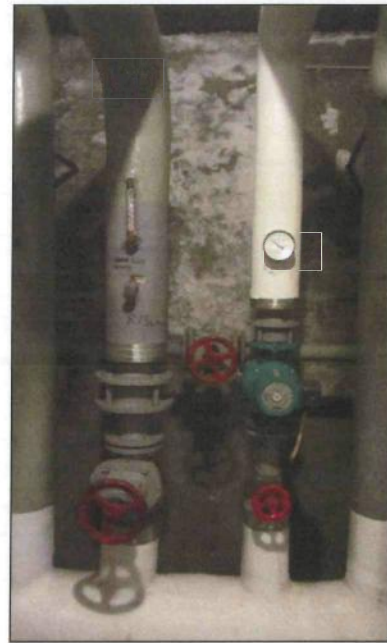
Heizungsverteilung, Heizkreis Schule mit ungeregelter Umwälzpumpe
