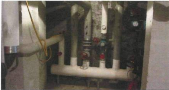
Heizkreis für Turnhalle (rechts) mit geregelter Effizienzpumpe
